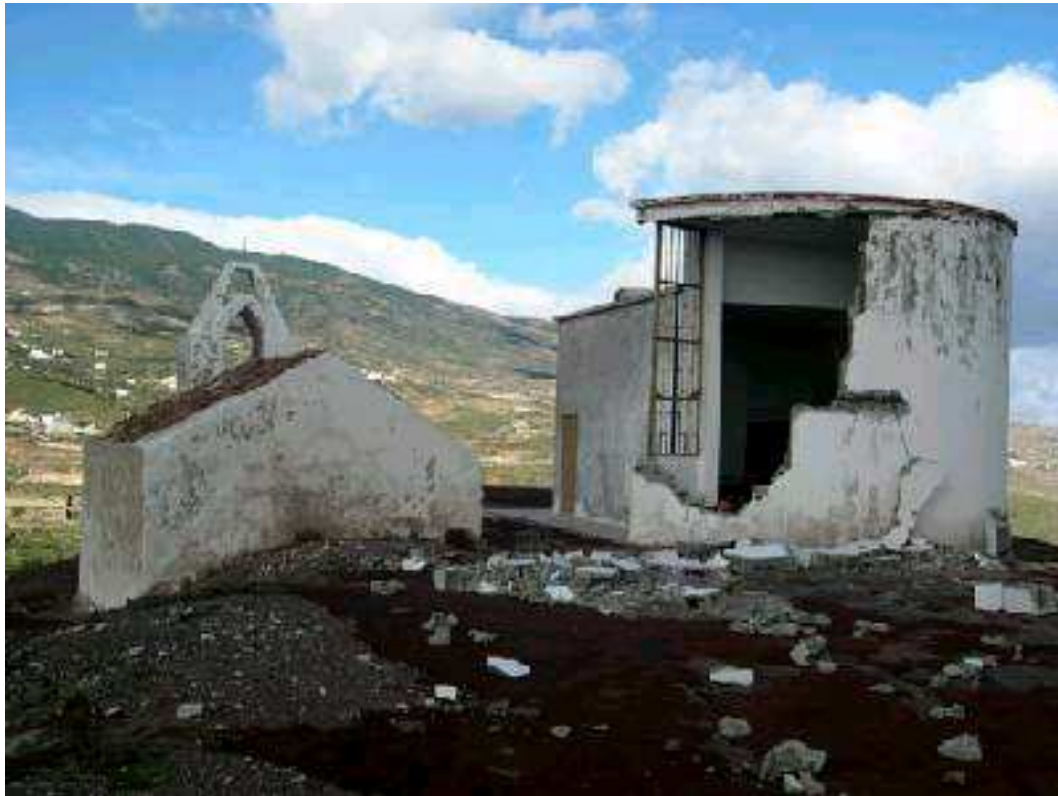
Los daños producidos en la ermita nueva por la tormenta tropical “ Delta ”.
