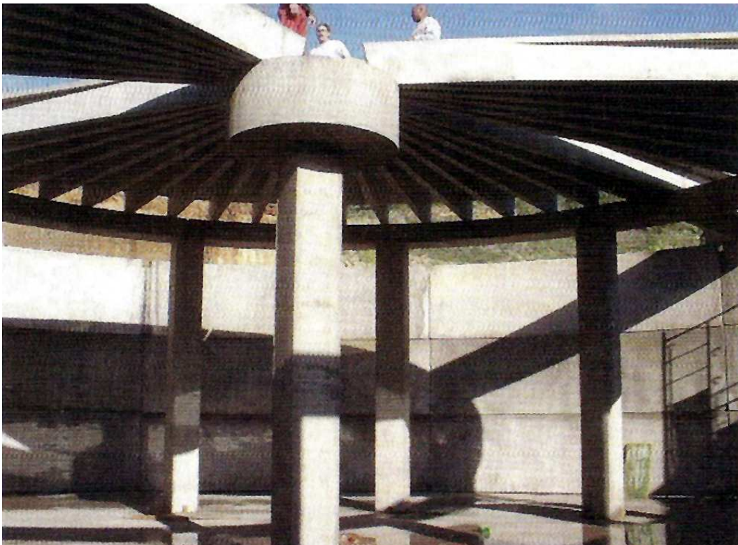
El actual depósito de cabecera de El Escobonal, cuando aún estaba en construcción en la parte alta de la Tambora de Arriba, en la zona conocida como Los Escobones.
